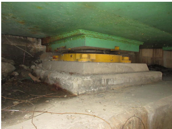
받침 콘크리트 파손 A2-SH2
